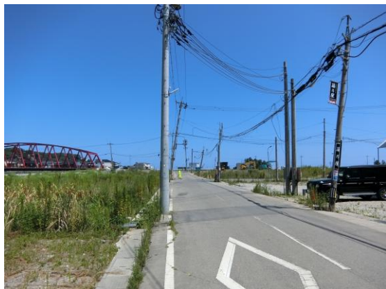
▲地震により歪んだままの電柱
